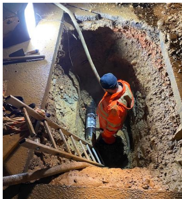
Fuite d'eau rue du Combal le 30 novembre 2020. Constatée à 19 heures, travaux terminés à 23h.
